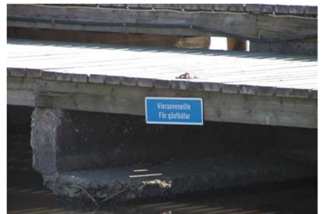
Kuva 81: Laivasillan huonokuntoinen päälaituri
