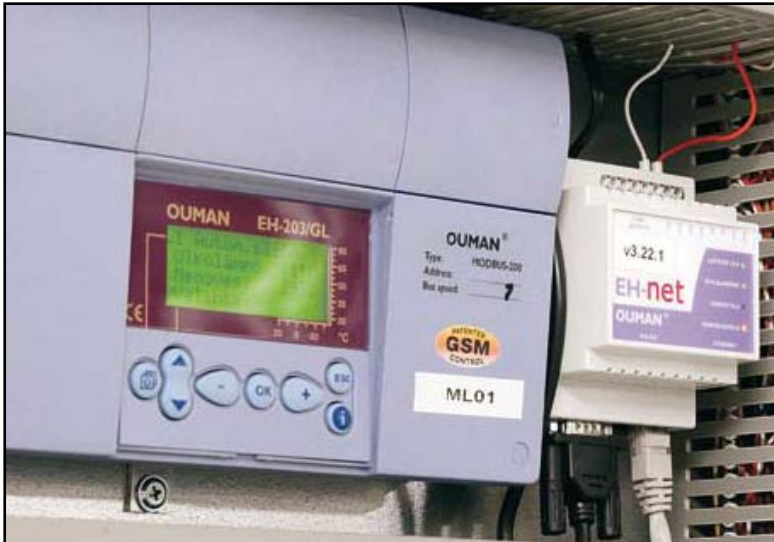
Kuva 3. Ouman EH-net -palvelin asennettuna EH-203 –lämmönsäätimen yhteyteen
